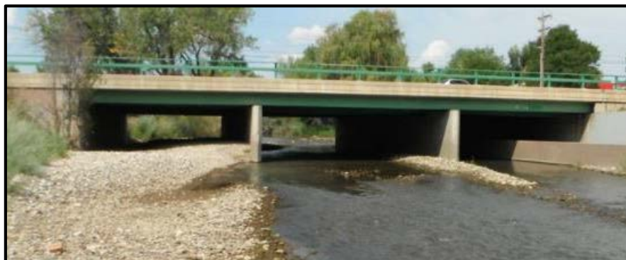
شکل ۳-۴۶- گرفتگی یکی از دهانه‌های پل توسط رسوب
