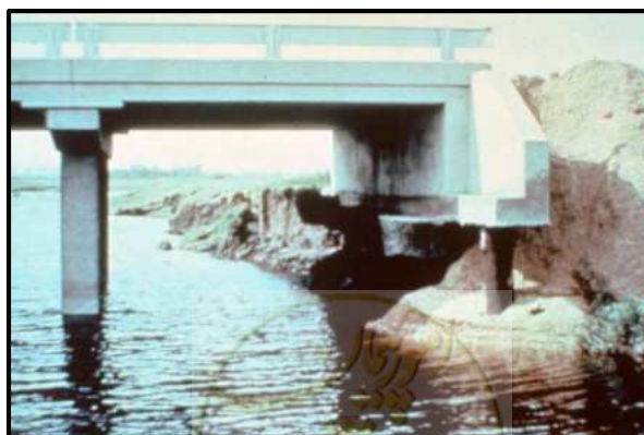
شکل ۳-۵۹- آبشستگی تکیه‌گاه پل و خاکریز دسترسی [۱۲۷]
