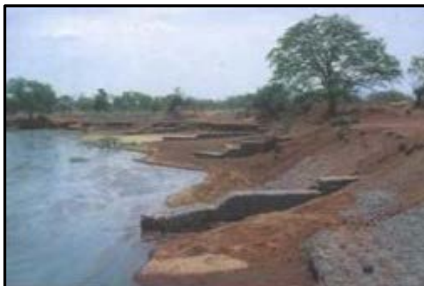
شکل پ. ۴-۲۳-آبشکن‌های کوتاه در حفاظت دیواره‌ی رودخانه در بالادست پل
