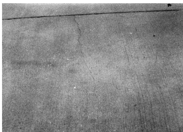
شکل ۸۰ خرابی ترک خوردگی انقباضی.
