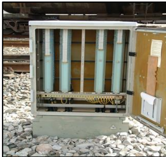
شکل ۵-۶- نمایش از جعبه DC نصب شده
