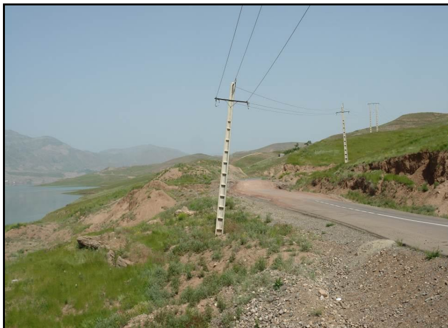
شکل ۱-۲۰- کج شدن تیر برق
