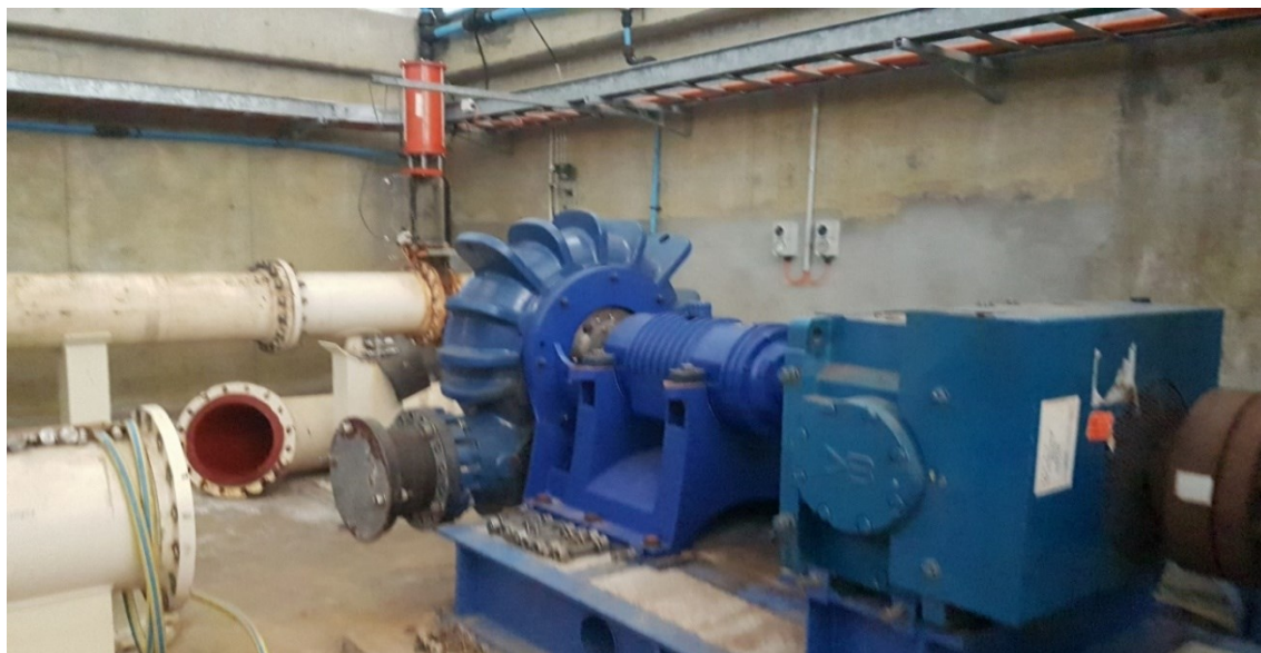
شکل ۲-۷- نمایی از پمپ‌های اسلاری مورد استفاده در سیستم گذردهی رسوب رودخانه توتید
