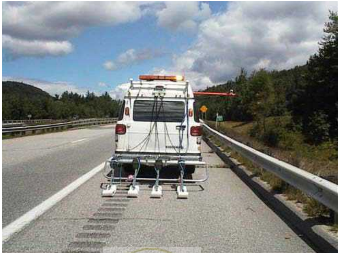
شکل (۳-۲۹) خودروی برداشت GPR در حال عملیات در جاده برای شناسایی عمقهای کم
