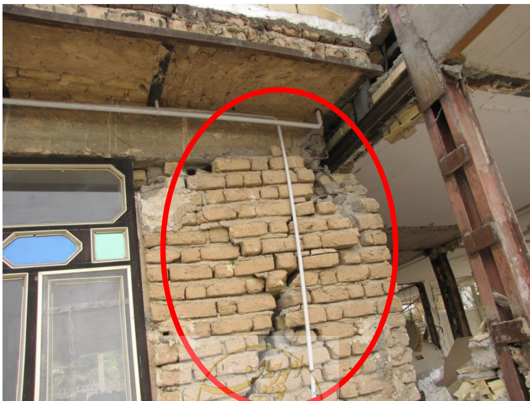
شکل (۶-۸): خرابی در سیستم باربر قائم در یک ساختمان مصالح بنایی بدون کلاف
