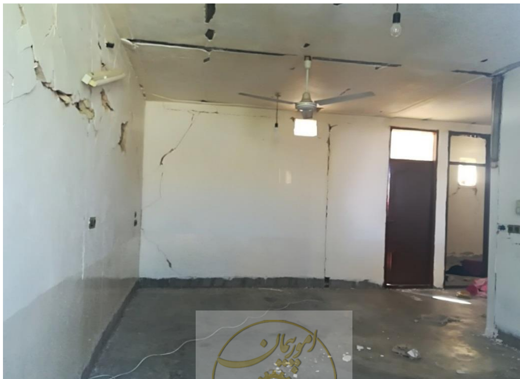
شکل (۶-۲۶): وجود خرابی در چندین دیوار در یک طبقه ساختمان مصالح بنایی کلاف‌دار
