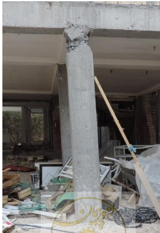
شکل (۵-۹): نمونه‌ای از آسیب ستون با شکل‌گیری مفصل پلاستیک در بخش فوقانی
