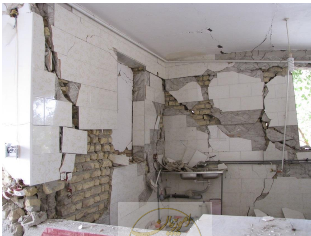
شکل (۶-۱۴): دیوارهای با ترک مورب پله‌ای شکل بزرگ در یک ساختمان مصالح بنایی بدون کلاف
