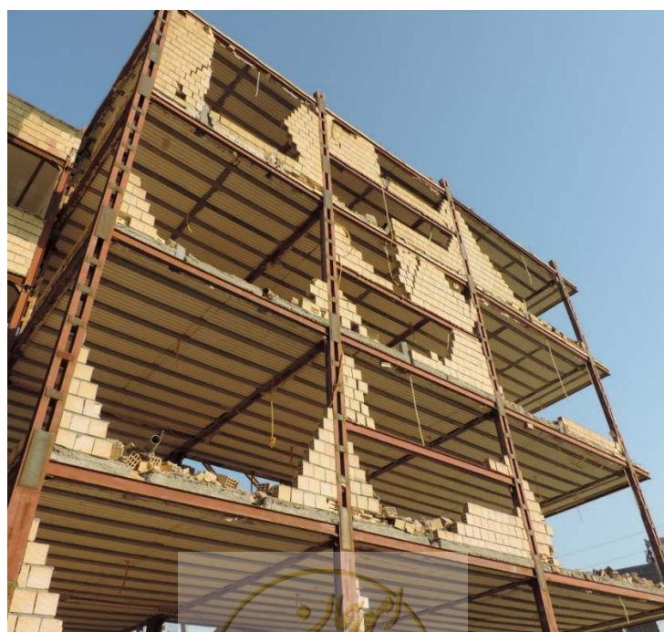
شکل (۴-۳۲): میانقاب‌های کج شده با احتمال ریزش در پس‌لرزه‌ها
