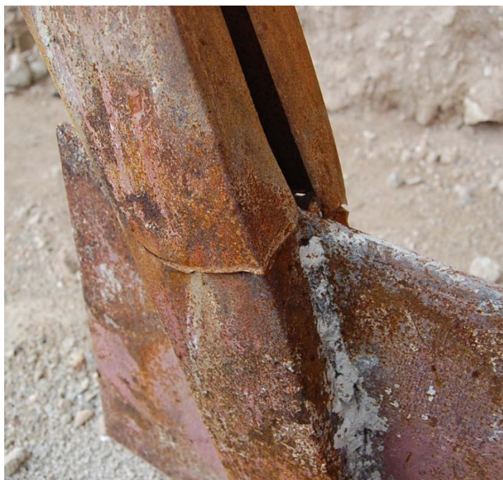
شکل (۴-۱۵): گسیختگی مهاربند (شکست کششی)
