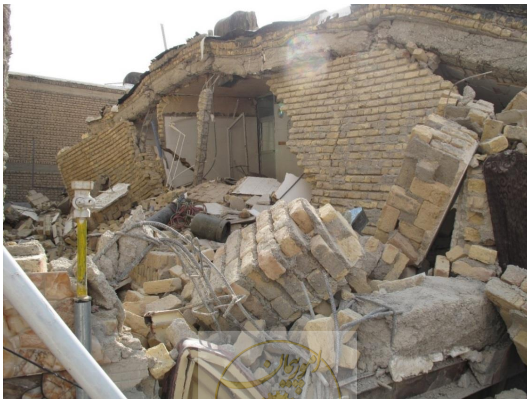
شکل (۶-۲۲): دیافراگم شکسته در یک ساختمان مصالح بنایی کلاف‌دار
