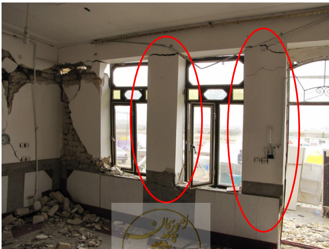
شکل (۶-۱۲): نا شاقول بودن اعضای باربر ثقلی در یک ساختمان مصالح بنایی بدون کلاف
