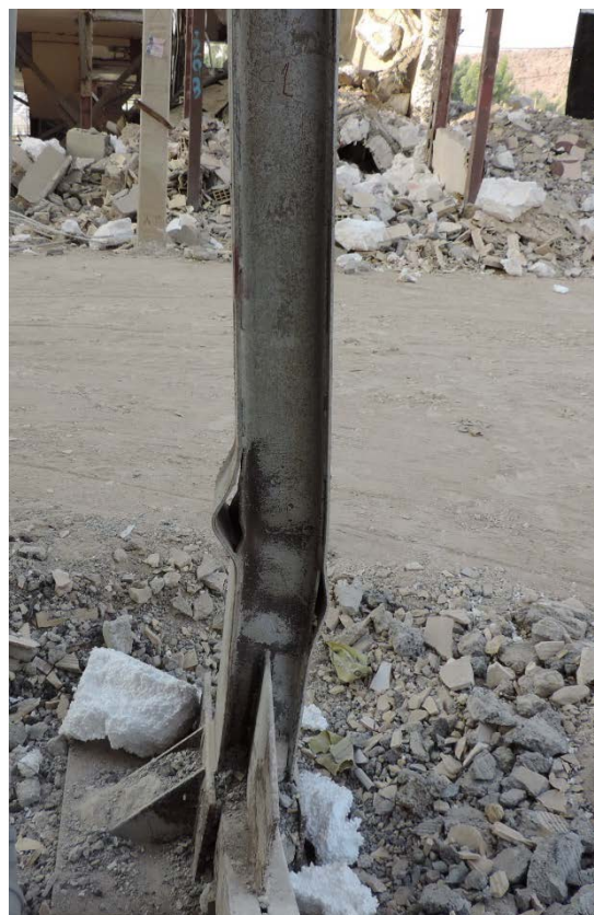
شکل (۴-۷): کمانش کلی ستون، کمانش موضعی، تشکیل مفصل پلاستیک
