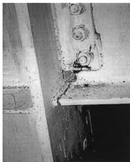
شکل (۴-۲۹): آسیب در اتصال پیچی
