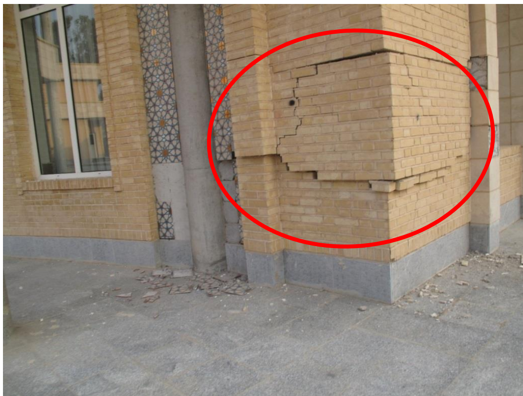
شکل (۶-۹): خرابی در سیستم باربر قائم در یک ساختمان مصالح بنایی بدون کلاف
