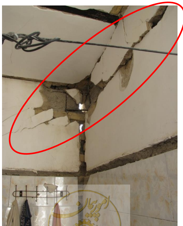
شکل (۶-۲۴): شکست اتصال برشی دیوارگرم به تیر در ساختمان مصالح بنایی با کلاف
