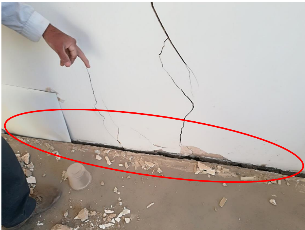
شکل (۶-۷): جداشدگی کف از سیستم باربر جانبی در یک ساختمان مصالح بنایی
