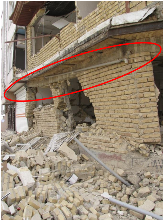
شکل (۶-۲۳): تیر لبه یا جمع کننده شکسته یا به شدت آسیب دیده در یک ساختمان مصالح بنایی کلاف دار
