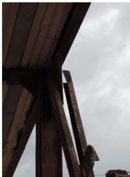
شکل (۴-۱۴): آسیب در جوش مهاربند
