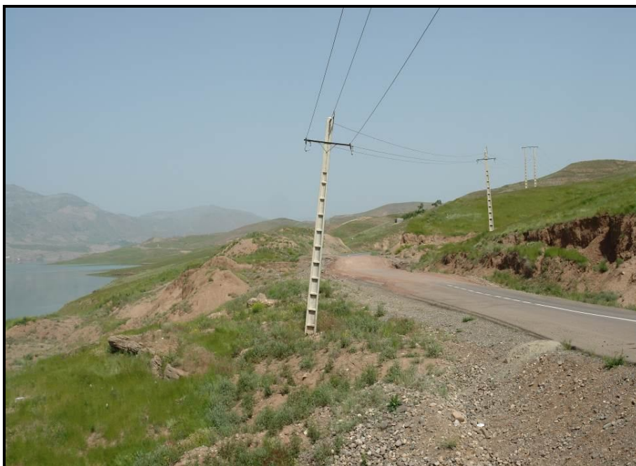
شکل ۱-۲۰- کج شدن تیر برق
