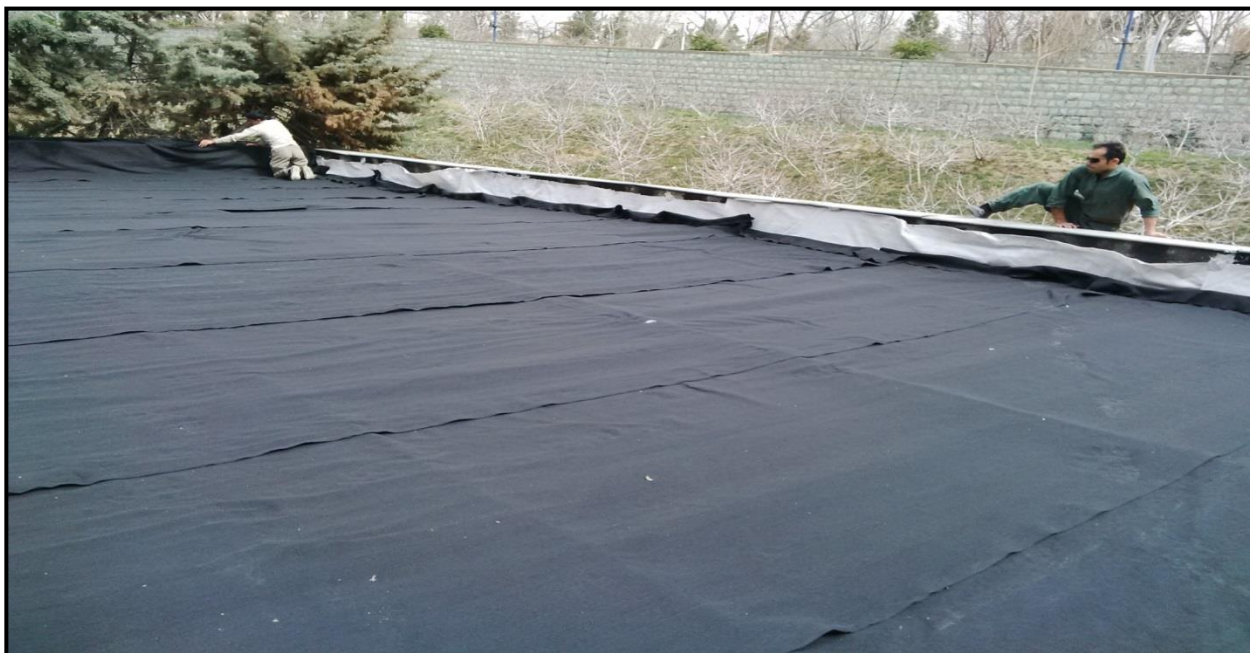
شکل پ.۱-۹- قرار دادن لایه ژئوتکستایل صافی؛ پهن کردن این لایه با هم پوشانی ۱۰ سانتی متری بر روی سقف صورت می‌گیرد. این لایه در بدنه عمودی جان پناه امتداد می‌یابد و توسط توری ثابت شده و روی آن ملات ماسه سیمان اجرا می‌شود.
