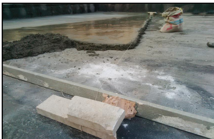
شکل پ.۱-۶- اجرای لایه ماسه سیمان به همراه شیب‌بندی بام به سمت آبراه‌ها
