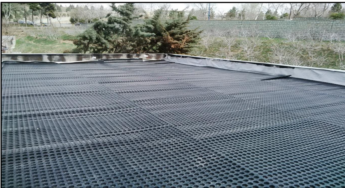
شکل پ.۱-۸- قرار دادن لایه زهکش؛ پهن کردن این لایه با هم پوشانی ۱۰ سانتی متری بر روی سقف صورت می گیرد. برای این منظور حفره ها در یکدیگر جاگیر می شوند.
