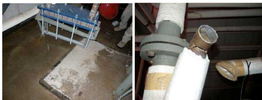
شکل پ 2-20- خرابی لوله مسی آب گرم بیمارستان san carlos در زلزله 2010 شیلی این خرابی بر اثر جابجایی بویلری که به نحو مناسبی مهار نشده بوده است اتفاق افتاده است.
