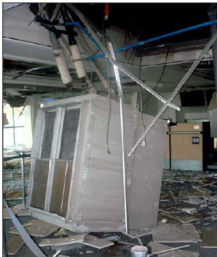
شکل پ 2-14- افتادن واحد HVAC معلق واقع در سقف در ترمینال فرودگاه سن دیگو در زلزله 2010 با بزرگا 8/8 شیلی
