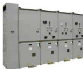
شکل 1-113- صفحه کلید ولتاژ متوسط (نصب شده بر روی کف)
