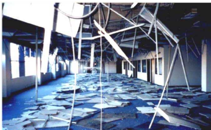
شکل پ 2-4- خرابی و فروریزش سقف کاذب و چراغ‌های سقفی در زلزله 1994 نورث ریج
