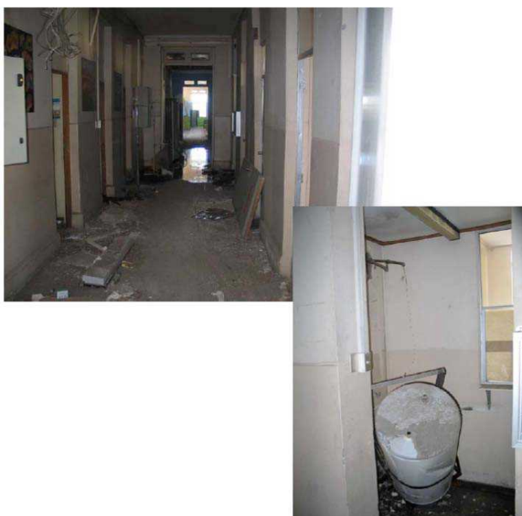
شکل پ 2-19- آسیب دیدگی مخازن آب در بیمارستان talca در زلزله 2010 شیلی. آب در سطح بیمارستان از مخازن پخش شده بود. این بیمارستان به علت آسیب‌های وارده به اجزاء غیرسازه‌ای که یکی از اصلی‌ترین آنها آسیب ناشی از آب بود با وجود سالم ماندن خود بیمارستان برای مدت قابل توجهی بعد از زلزله تعطیل بود.
