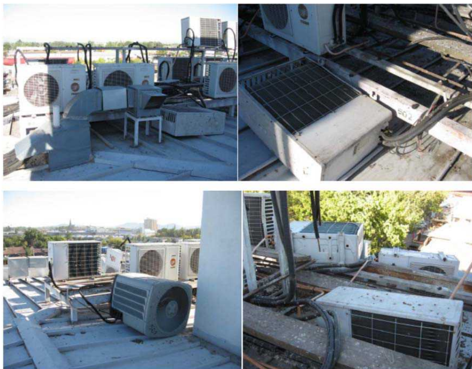
شکل پ 2-13- افتادن و خرابی تعداد زیادی از تجهیزات واقع بر سقف به علت مهار نامناسب در زلزله 2010 شیلی
