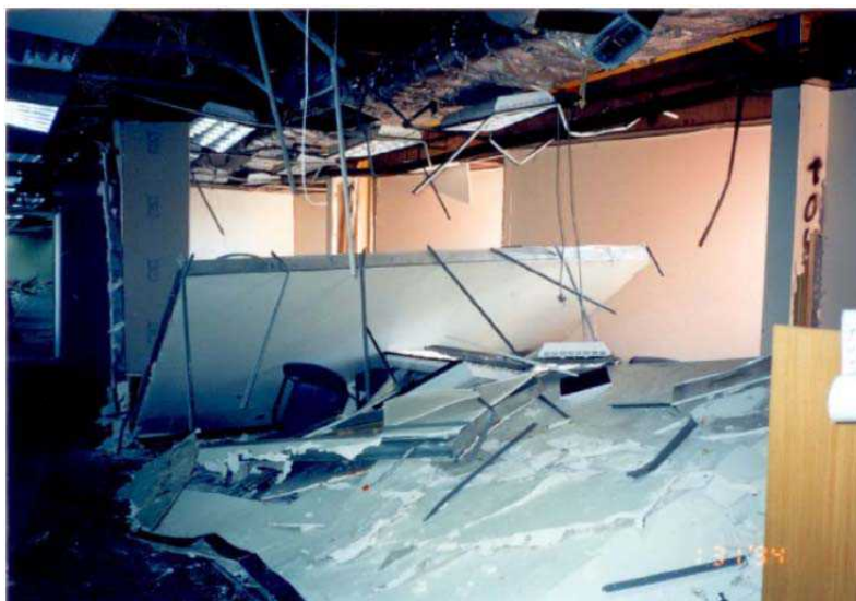
شکل پ 2-8- خرابی مهارهای نامناسب پارتیشن نیمه ارتفاع فلزی در زلزله 1994 نورث ریج
