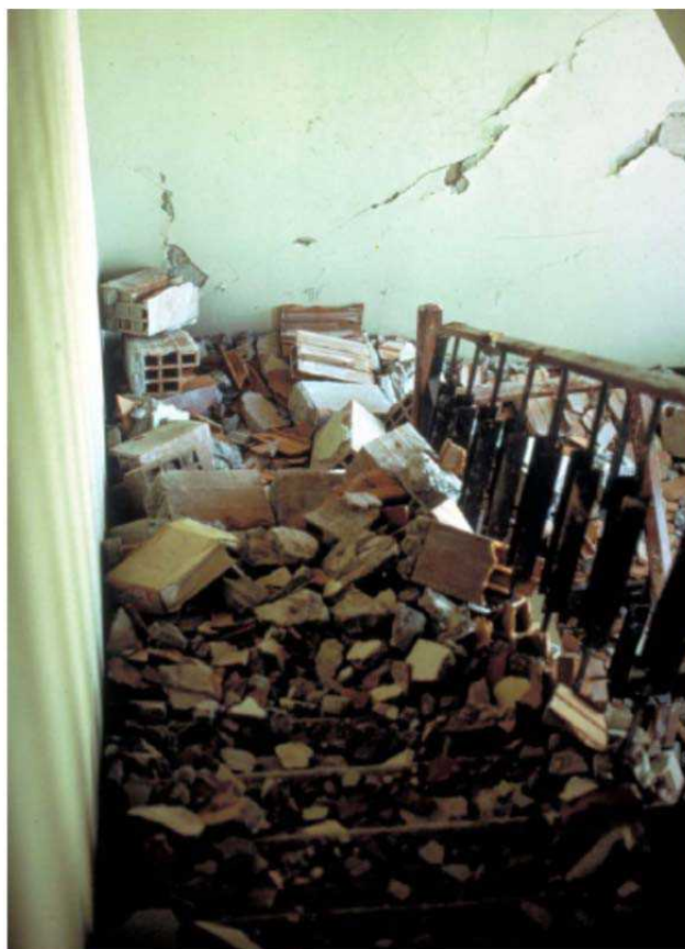
شکل پ 2-6- نمونه‌ای از پوشیده شدن راه‌پله‌ها از تکه‌ها و قطعات ناشی از خرابی پارتیشن‌های اطراف راه‌پله که باعث غیرقابل استفاده شدن راه‌پله پس از زلزله گردید (زلزله 1972 نیکاراگوا- بزرگا 6/2)
