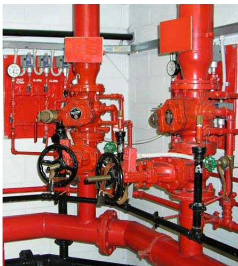
شکل 1-84- سیستم اطفاء حریق شامل لوله‌ها و کلیدهای فشار و شیرهای مونیتورینگ
