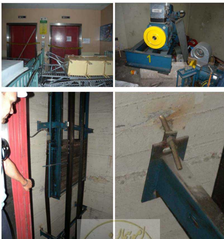
شکل پ 2-24- آسیب وارده به آسانسور در زلزله 2010 شیلی، موتور مهارنشده آسانسور از تکیه‌گاه خود خارج شده ریل‌های جابجایی آسانسور تحت اثر بار قائم وارده خم شده‌اند و بولت‌های اتصال ریل از بتن خارج شده‌اند.
