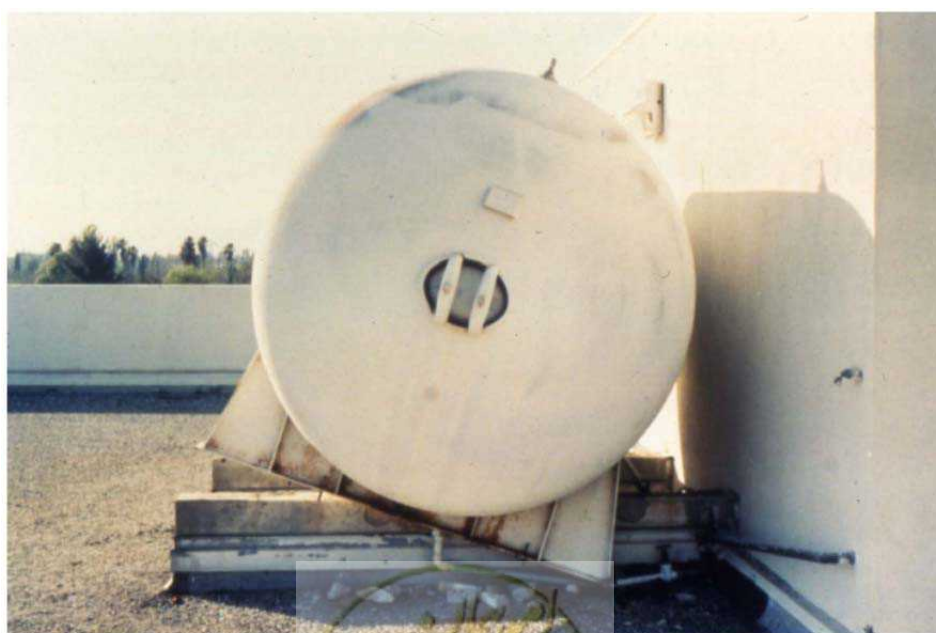
شکل پ 2-15- جابجایی و خارج شدن مخزن واقع بر روی بام بیمارستان گراناذا هیل در زلزله نورث ریج که باعث از مدار خارج شدن مخزن و خرابی لوله‌های منتهی به آن شده است.
