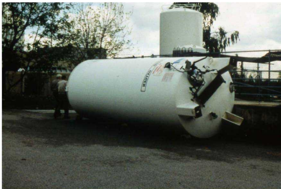
شکل پ 2-16- خرابی و افتادن مخزن قائم در بیمارستان بر اثر مهار ناکافی در اثر زلزله 1994 نورث ریج
