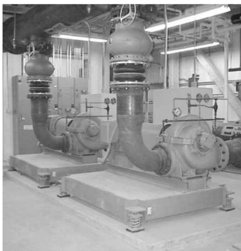
شکل 5-158- نمونه استفاده از اتصال شکل پذیر در محل اتصال لوله به پمپ
