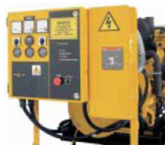
شکل 1-92- دستگاه کنترل ژنراتور (نصب شده بر روی تجهیزات)
