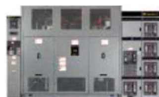
شکل 1-108- پست فرعی برق (نصب شده بر روی کف)
