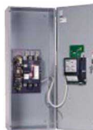
شکل 1-85- سوئیچ انتقال اتوماتیک (نصب شده بر سطح دیوار)
