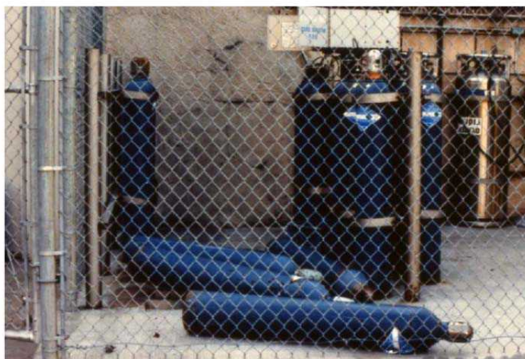
شکل پ 2-17- افتادن و خطر انفجار سیلندرهای اکسیژن مهار نشده در زلزله نورث ریج 1994
