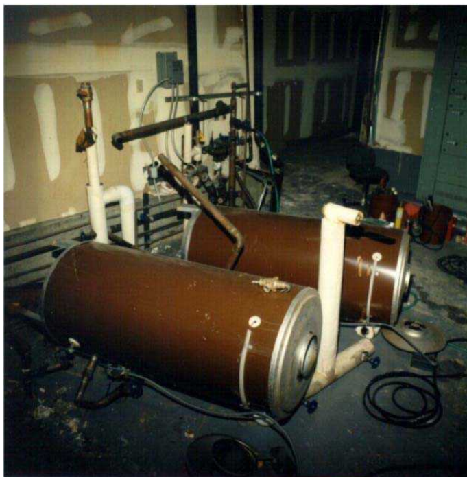
شکل پ 2-18- واژگونی آبگرمکن مهار نشده بر اثر زلزله
