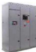
شکل 1-109- تابلوهای برق (نصب شده بر روی کف)
