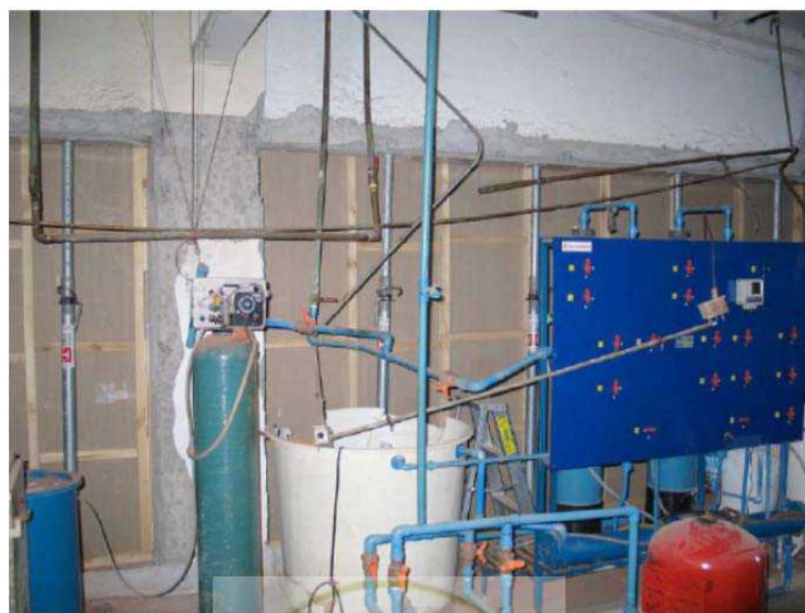
شکل پ 2-7- خرابی دیوار میان قابی آجری و افتادن آن بر روی دو مخزن آب 600 لیتری آب شد که باعث ورود آب به 3 تا از 6 اتاق عمل بیمارستان واقع در شیلی شد و از مدار خارج شدن آنها گردید (زلزله 2010 شیلی)
