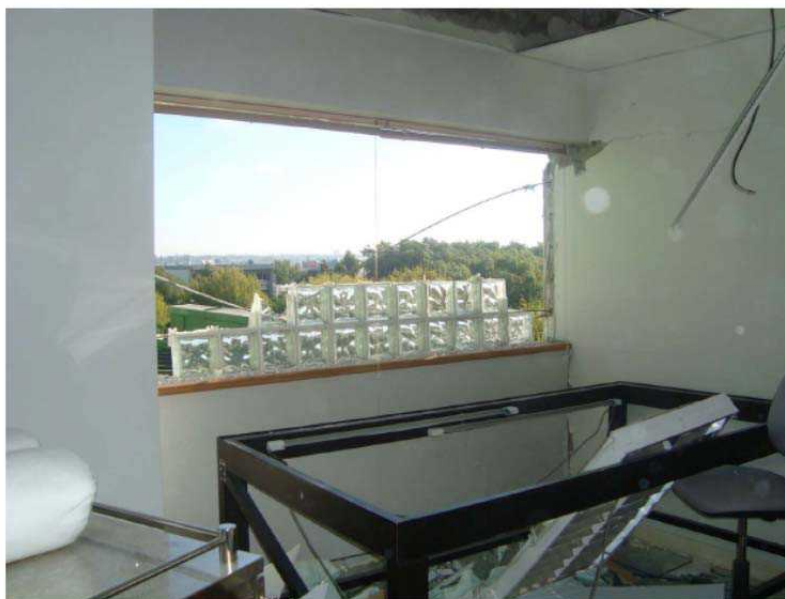
شکل پ 2-2- آسیب وارده به پانل‌های شیشه‌ای در بیمارستان در زلزله 2010 شیلی
