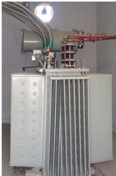
شکل ۱-۱۴۱- ترانس برق فشار قوی
