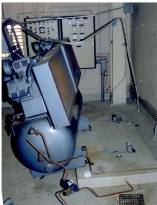
شکل پ 2-12- خرابی کمپرسور متصل به کف به وسیله جداساز ارتعاش کف نامناسب در زلزله 1994 نورث ریج
