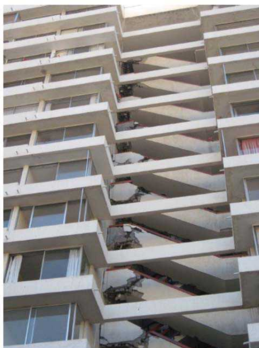
شکل پ 2-10- خرابی راه‌پله تمام طبقات ساختمان در Vina del mar در زلزله 2010 شیلی به بزرگا 8.8 راه‌پله‌ها به صورت صلب به طبقات متصل شده بودند و به صورت بادبند قطری عمل کرده‌اند در حالی که برای این طراحی نشده‌اند.
