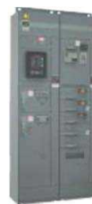
شکل 1-121- مرکز کنترل اندازه‌گیری ولتاژ پائین (نصب شده بر روی کف)
