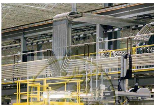
شکل 1-83- لوله تحت فشار
