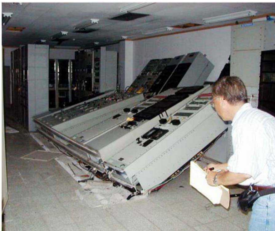
شکل پ 2-21- خرابی و واژگونی پانل‌ها در زلزله 1985 مکزیکوسیتی با بزرگای 8
