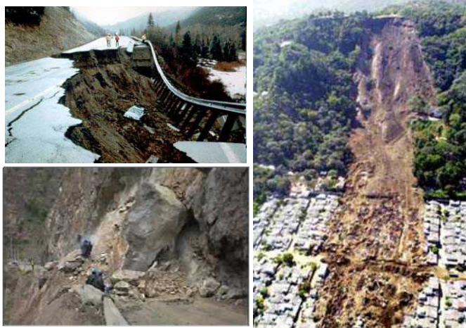
پ-2-6- مدفون شدن ساختمانها و تخریب راه اصلی بر اثر زمین لغزش
