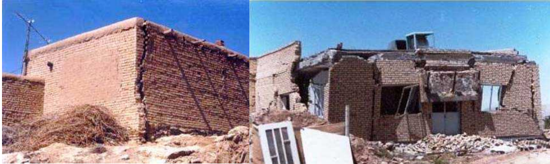
جداشدن دیوارها و نریختن سقف سبک چوبی (زلزله قائن ۱۳۸۴)
