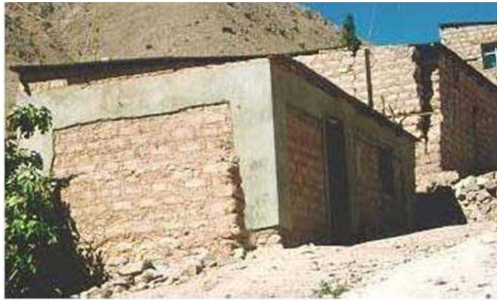
شکل پ-2-21- ساختمان جلو به دلیل داشتن کلاف آسیب‌ن دیده ولی ساختمان بدون کلاف آسیب دیده است.
