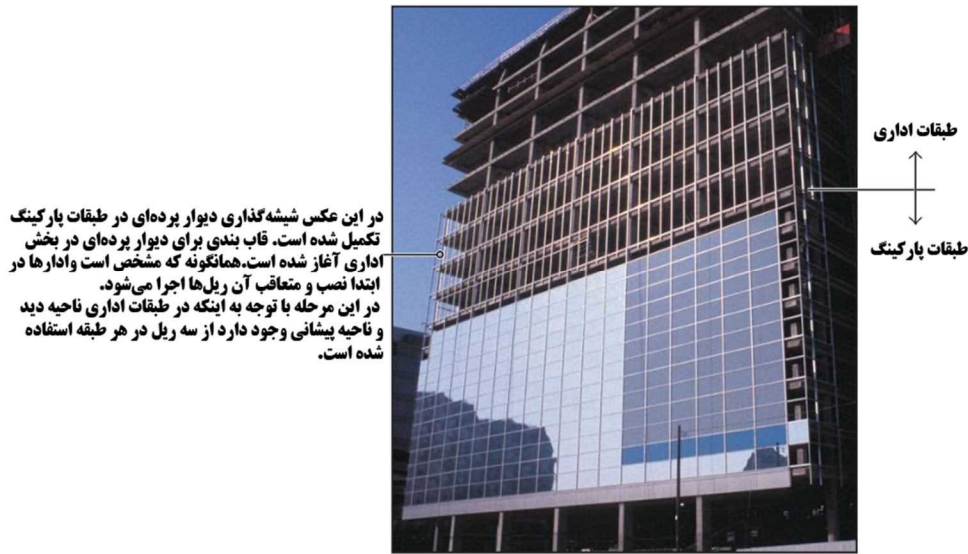
شکل ۸-۷- مراحل نصب دیوار پرده‌ای شیشه-آلومینیوم درجا در یک ساختمان اداری که در آن طبقات زیرین پارکینگ و طبقات بالایی اداری است.
