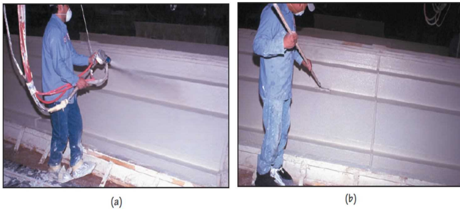
شکل ۶-۴۱-الف) پاشیدن مخلوط GFRG بر روی لایه آستر. (ب) متراکم کردن مخلوط با استفاده از روش غلتک زنی در لبه ها و گوشه های قالب
