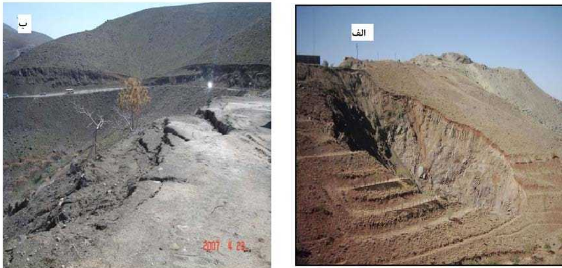
شکل (۱-۲) نمای از حفره ریزشی در داخل روباره تونل (الف) و ترکهای کششی در بالای حفره ناشی از گسترش آن (ب) (قاسمی و همکاران، ۱۳۸۶)
