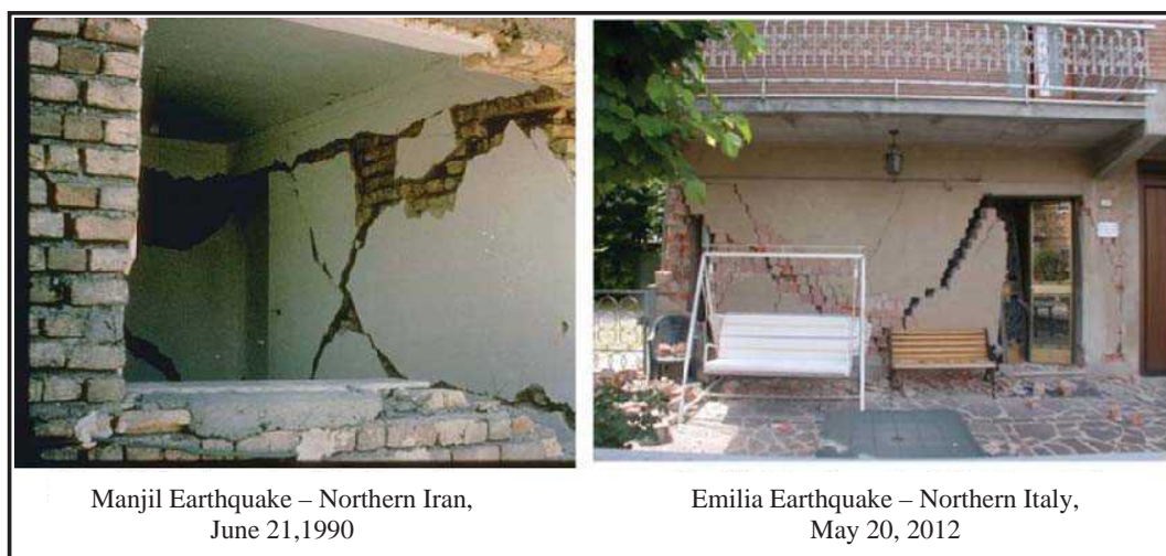
شکل 1-9- بروز ترک‌های قطری در دیوارهای بنایی غیرمسلح در زلزله‌های منجیل و امیلیا
