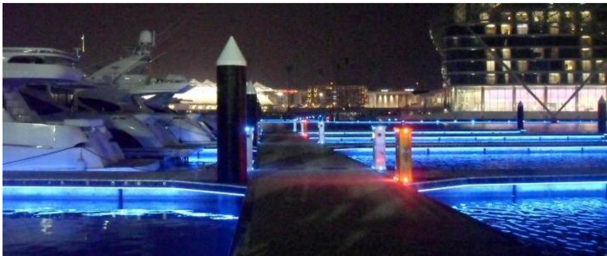
شکل ۱-۲۳- کنترل روشنایی و محوطه
