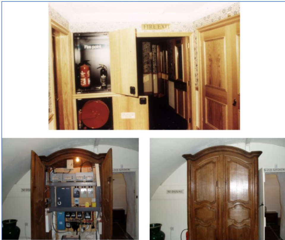
شکل ۱-۶: استتار جعبه کلیدهای مربوط به سیستم‌های ایمنی و شلنگ‌های آتش‌نشانی با جزئیاتی هماهنگ با مبانی چیدمان منطبق بر اسناد تاریخی و منطبق بر تزئینات داخلی فضا و در صورت نیاز از جنس مصالح مقاوم‌سازی شده در برابر حریق
