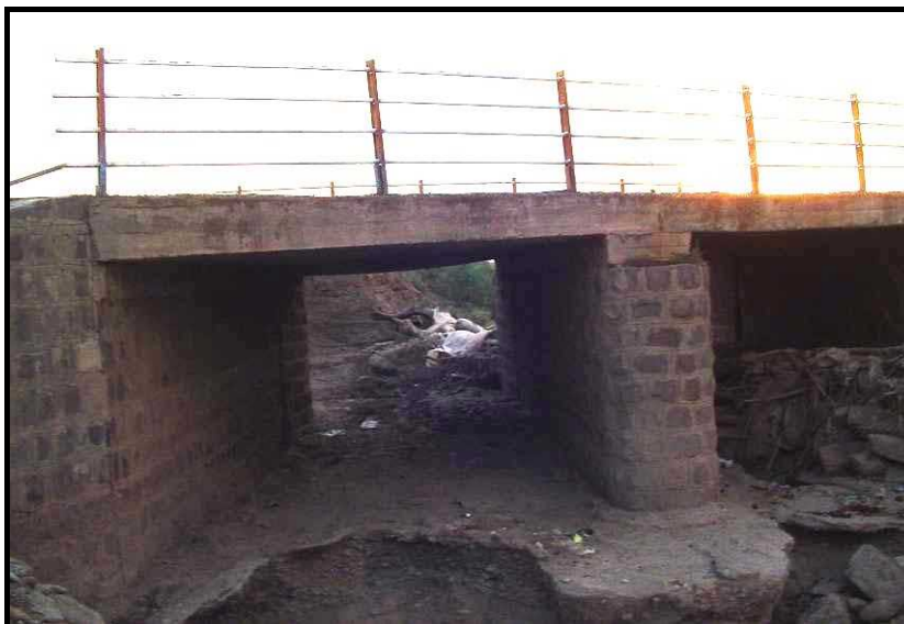
شکل ۷-۱۹- آبخستگی شدید در بستر و تخریب پی در محل پایه‌ها در مسیل فروان
