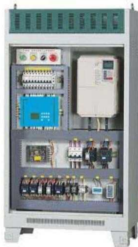
شکل (۴-۷). نمایی از داخل یک تابلو روشنایی
