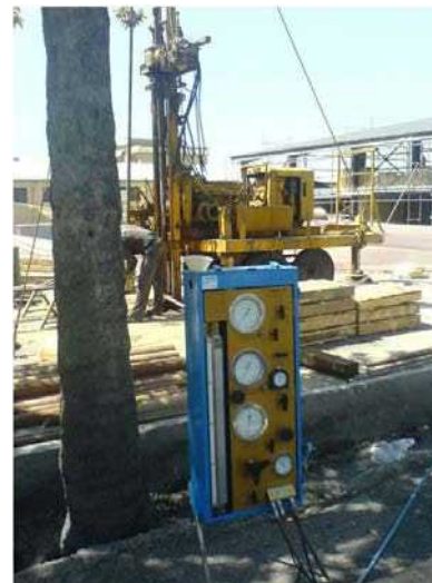
تابلوی کنترل پرسیومتر
