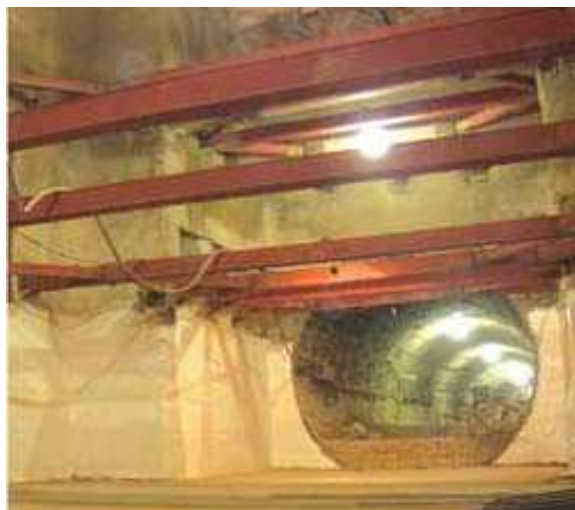
شکل ۱۳-۲- ورق‌های PVC تونل متروی تهران
