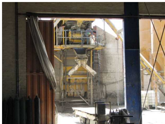
سیستم تخلیه بتن و وینچ به منظور حرکت باگت‌ها
