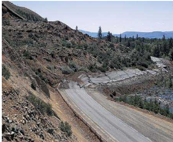
وقوع زمین لغزش و خرابی جاده
