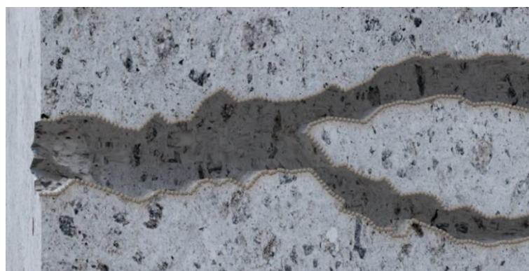
الف) نمایی از ترک در بتن
