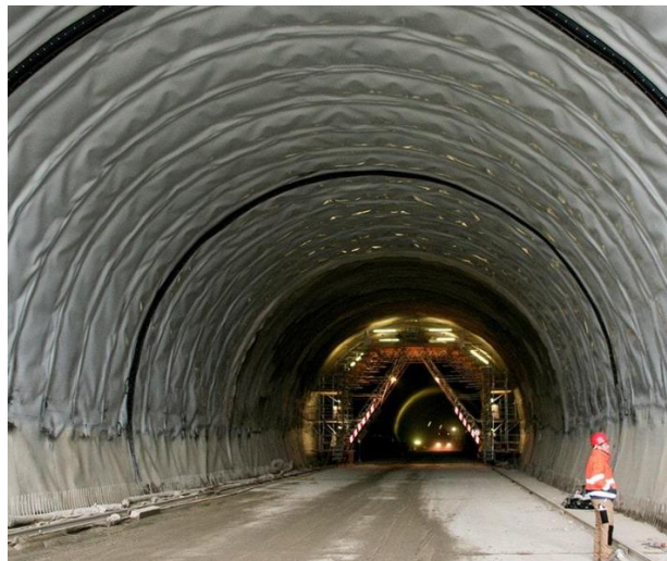
شکل ۱-۲- استفاده از ژئوممبران PVC در مسیر تونل قطار شهری
