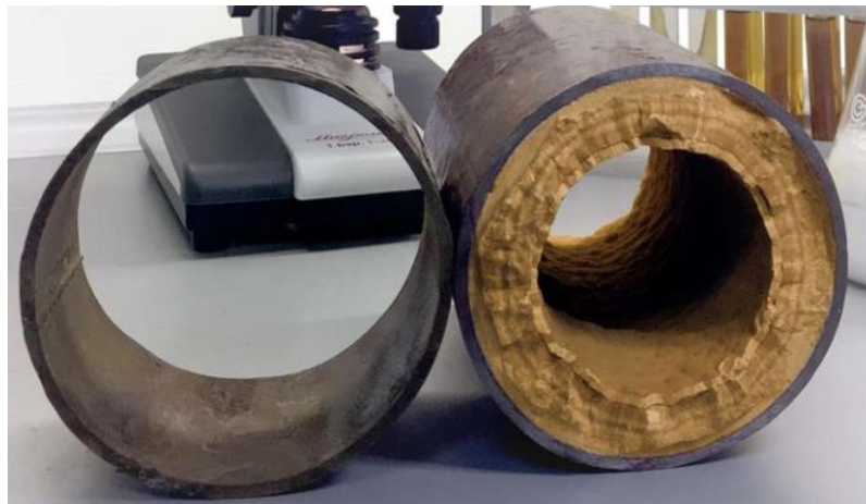
شکل ۴-۲- گرفتگی لوله بدلیل رسوبات معدنی
