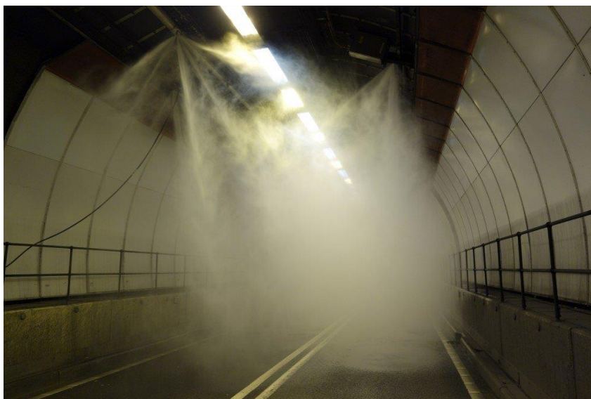
شکل ۳-۴- نمایی از دبی آب ورودی به تونل جهت اتفاء حریق
