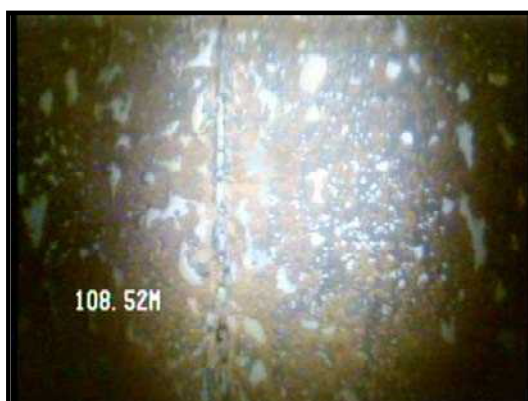
شکل پ.۱-۱۱- تصویر حاصل از ویدئومتری در عمق ۱۰۸/۵۲ متری
