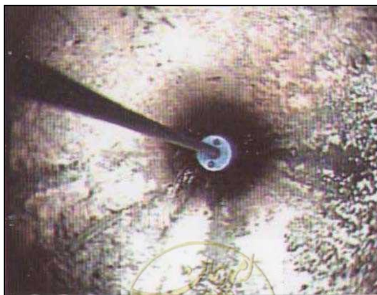
شکل ۴-۱۴- انسداد شبکه‌های لوله جدار
