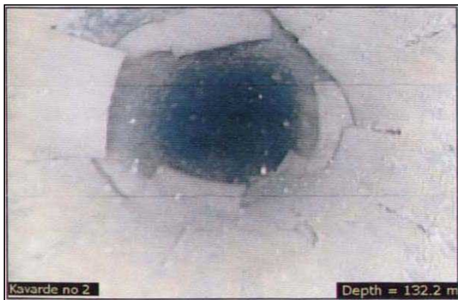
شکل ۴-۱۳- وجود پارگی در عمق ۱۳۲/۵ متری و عدم امکان تصویر برداری از اعماق پایین تر
