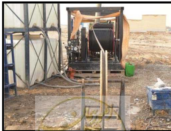
شکل پ.۱-۶- استفاده از سیستم مافوق فشار قوی
