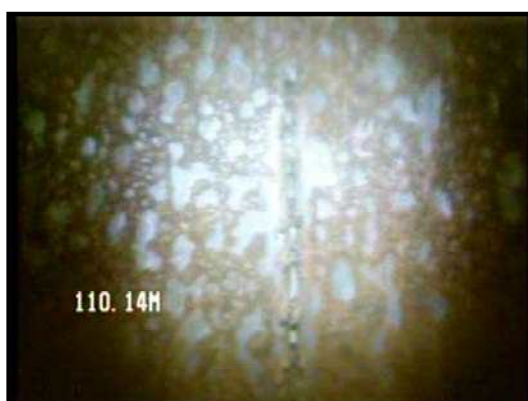
شکل پ.۱-۱۲- تصویر حاصل از ویدئومتری در عمق ۱۱۰/۱۴ متری
