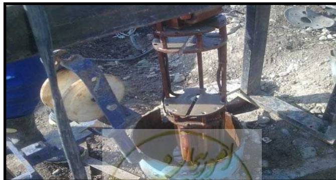
شکل پ.۱-۱۵- احیای چاه به وسیله مجموعه مافوق صوت
