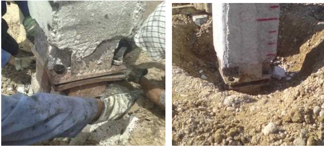
شکل الف-۸- تطویل شمع با اتصال پیچی. همانطور که در تصاویر فوق مشاهده می‌گردد، تراز نبودن صفحات اتصال باعث شده تا برای حفظ زاویه قائم محور شمع پیچها بطور کامل بسته نشود و اتصال بخوبی برقرار نگردد.
