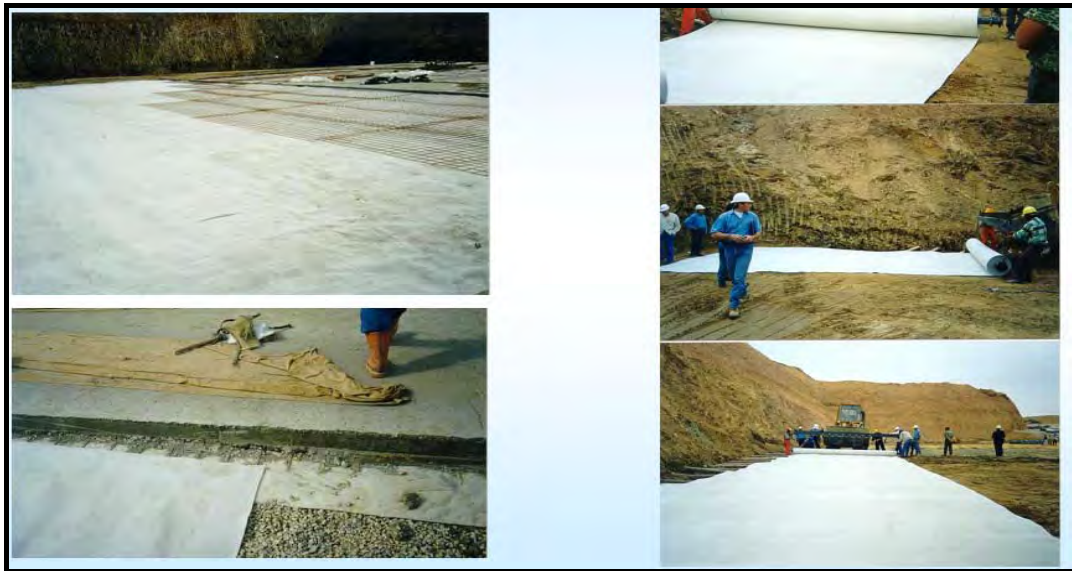
شکل ۳-۳۷- نمونه‌ای از کاربرد GCL در یک پروژه آب‌بندی مخزن
