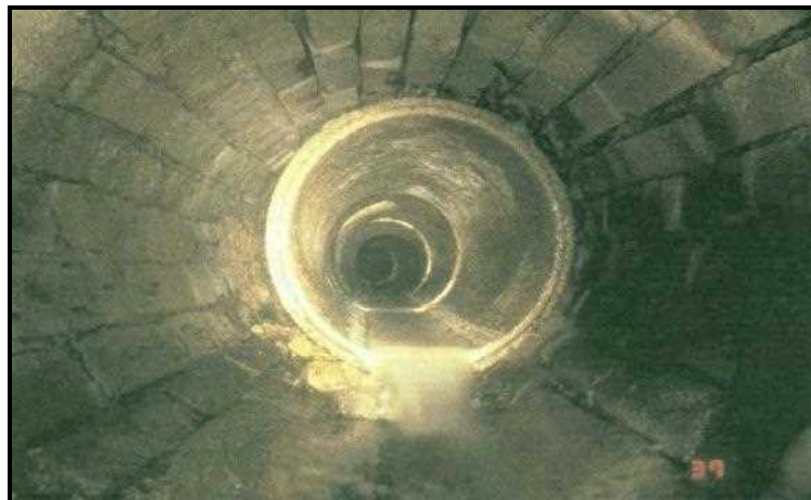
شکل ۶-۲۴- تغییر در جنس لوله از آجری به بتنی
