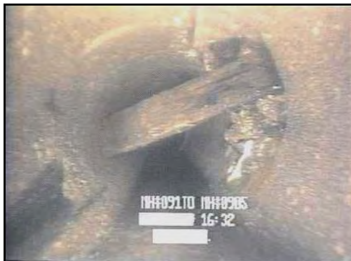
شکل ۶-۱۷-ج- نفوذ مانع به داخل لوله اصلی از طریق انشعابات از ساعت ۸ تا ساعت ۲
