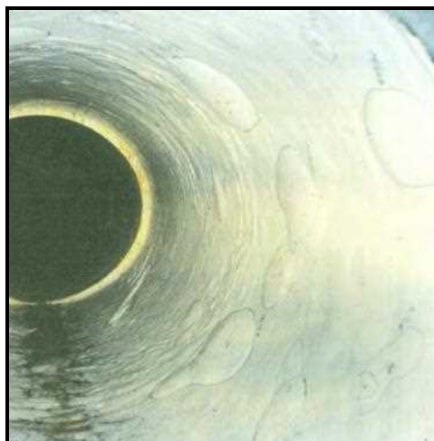
شکل ۶-۲۲-ب- ناول در پوشش داخلی لوله از ساعت ۱۲ تا ساعت ۶
