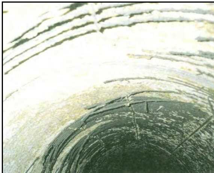
شکل ۶-۱۰-ز - آسیب سطحی، خوردگی در تسلیحات بتن از ساعت ۱۰ تا ۱
