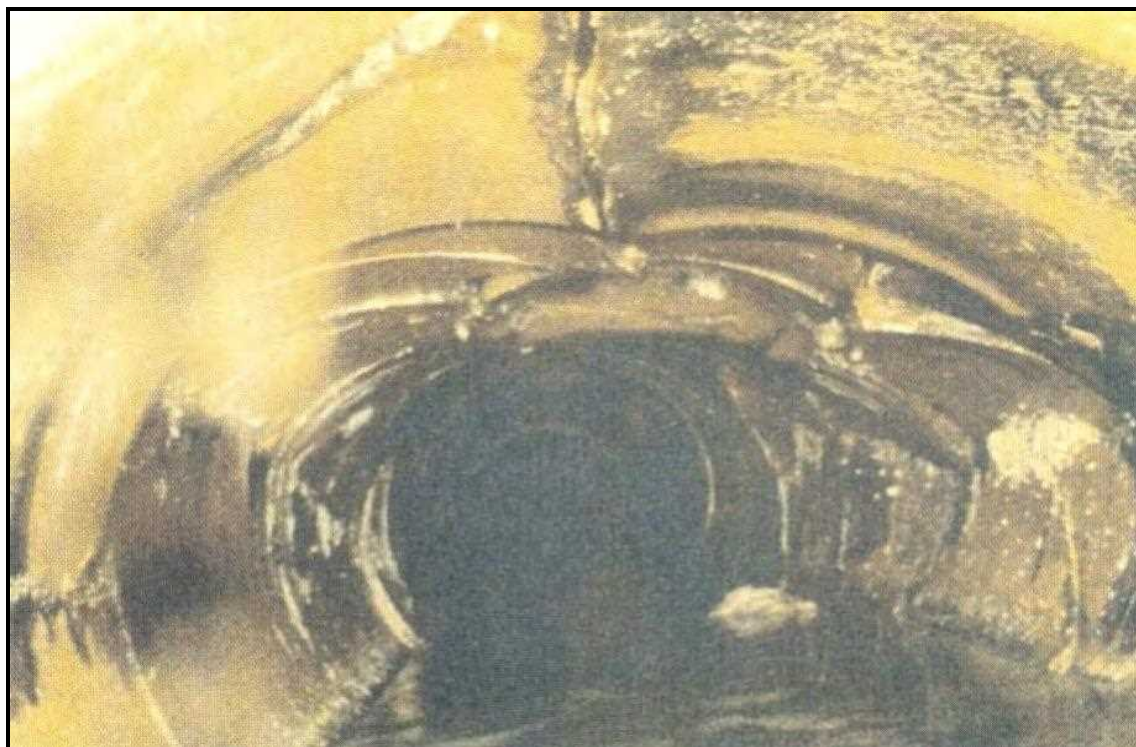
شکل ۶-۴ - شکستگی در لوله
