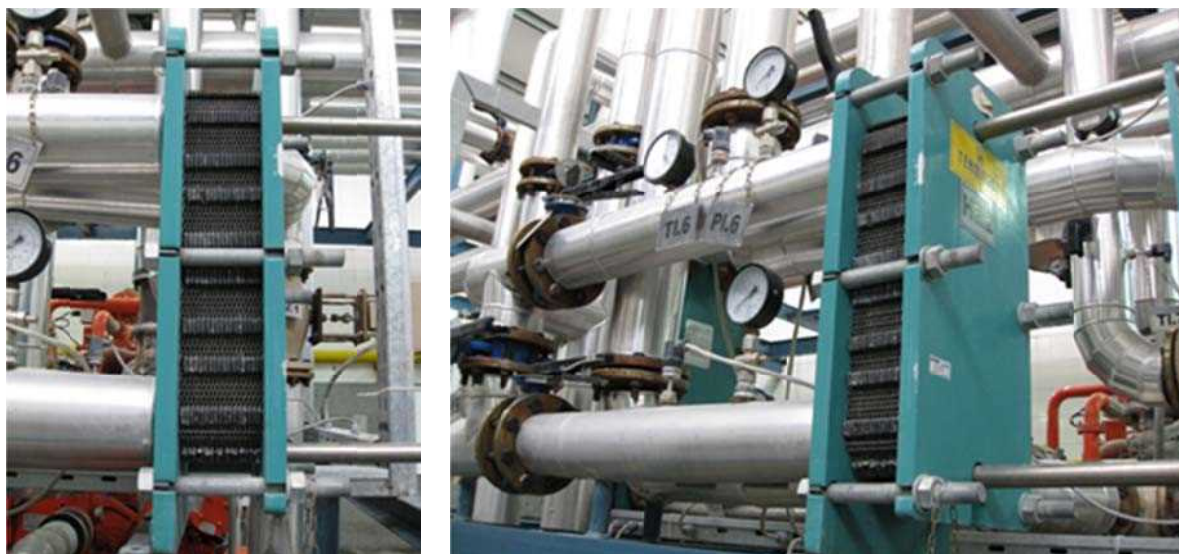
شکل ۴-۱۶- مبدل حرارتی جهت تولید آب گرم در CHP پروژه شماره ۶
