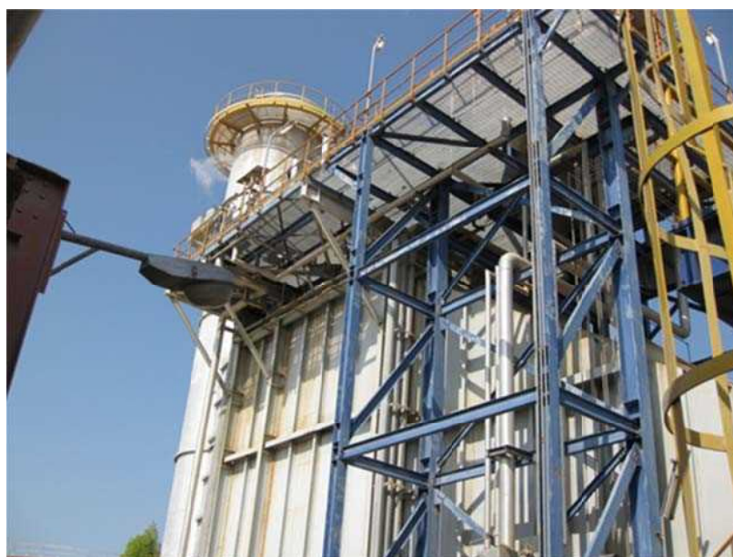
شکل ۴-۲۱- بویلر بازیافت (HRSG) در پروژه شماره ۷
