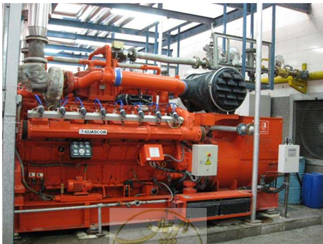
شکل ۴-۱۴- موتور GUASCOR مدل SFGLD 560 در پروژه شماره ۶
