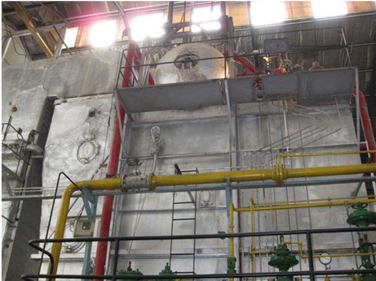
شکل ۲-۴- بویلر مربوط به پروژه شماره ۱
