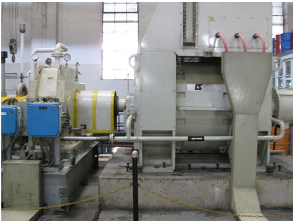
شکل ۳-۴- ژنراتور دستگاه CHP پروژه شماره ۱
