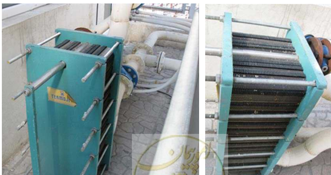
شکل ۴-۲۵- مبدل حرارتی جهت استفاده از حرارت آب خنک کننده بدنه موتور در CHP پروژه شماره ۹
