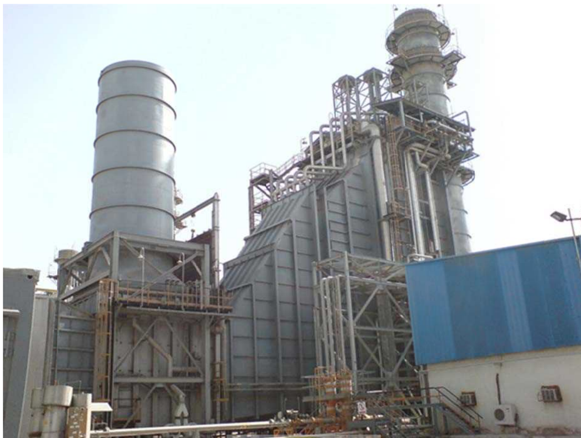
شکل ۴-۲۸- بویلر بازیافت (HRSG) در پروژه شماره ۱۰
