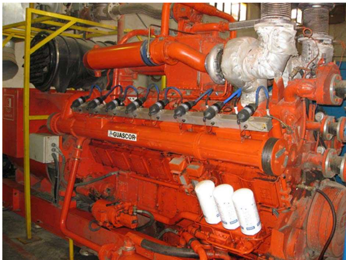
شکل ۴-۱۲- موتور GUASCOR مدل SFGLD 560 در پروژه شماره ۵
