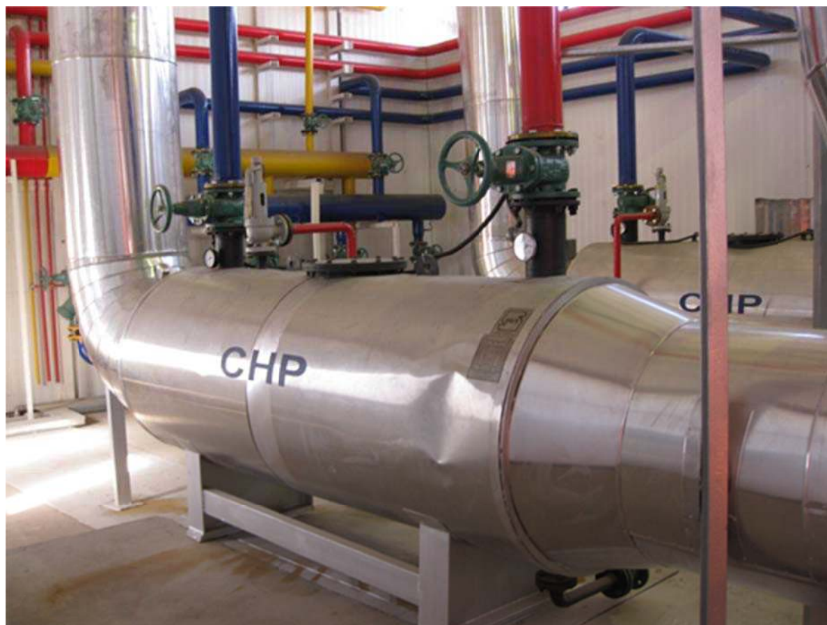
شکل ۴-۳۰- مبدل حرارتی در خروجی توربین در پروژه شماره ۱۱
