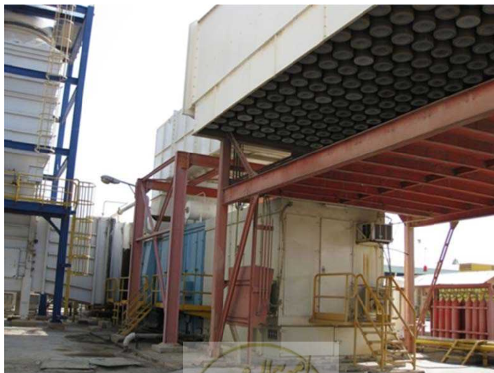
شکل ۴-۱۹- محل قرار گیری توربین گاز و فیلترهای ورود هوا در CHP پروژه شماره ۷
