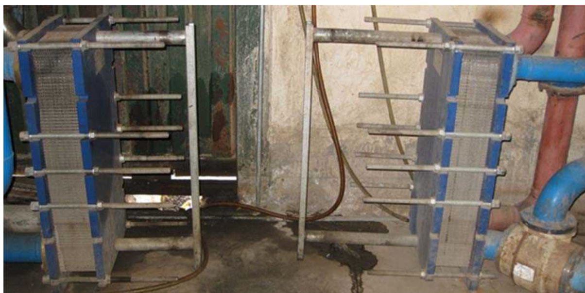
شکل ۱۳-۴- مبدل حرارتی جهت تولید آب گرم در پروژه شماره ۵
