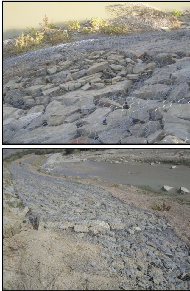
شکل ۴-۱- نمونه‌هایی از رخداد خرابی در توریسنگ‌ها
