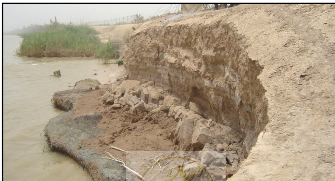
شکل ۲-۲- نمونه‌ای از رخداد پدیده ریزش کناره رودخانه
