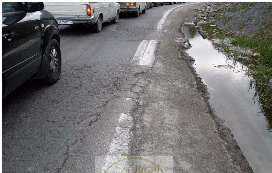
شکل پ ۸-۱- وجود روان آب در کناره های مسیر که منجر به بروز خرابیهای مختلف گردیده است
