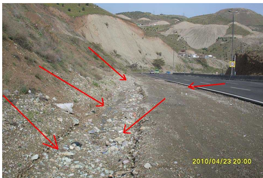
شکل پ-۱-۶- عدم وجود سیستم زهکشی طولی مناسب (عدم هدایت روان آب سرازیر شده از ترانشه ها و سطح راه)
