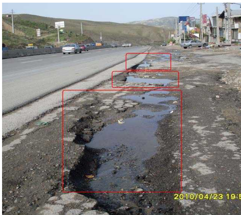
شکل پ ۱-۵ - نمونه‌ای از عدم وجود سیستم زهکش طولی و جمع‌شدگی آب
