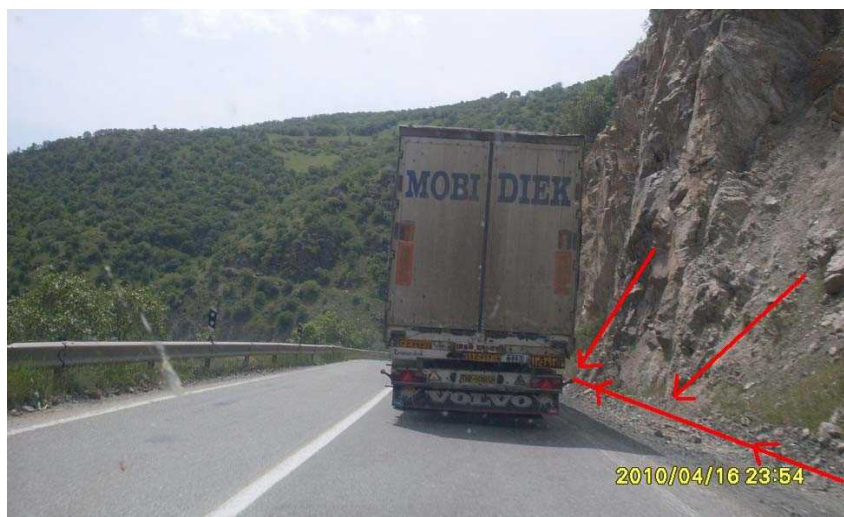
شکل پ ۱-۱- عدم وجود سیستم زهکشی طولی مناسب برای هدایت روان آب
