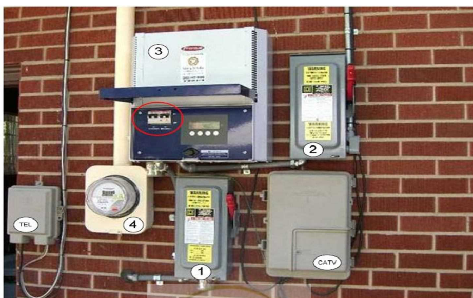
شکل (۳-۱۳): کلیدها و قطع کننده‌های سیستم فتوولتاییک ۱- قطع کننده AC، ۲- قطع کننده DC، ۳- مبدل همراه با کلید کلیدهای DC و AC و بر روی پانل مبدل با دایره قرمز رنگ مشخص شده است) و ۴- کنتور
