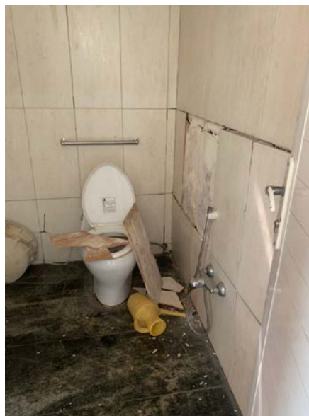
شکل پ- ۱۸: جدا شدن و تخریب کاشی‌ها از جداره‌های داخلی
