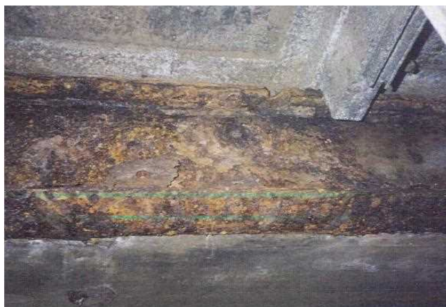
شکل ۱-۶۳ خوردگی تیر فولادی در سقف سازه
