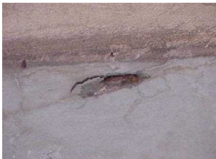
شکل ۴۰-۴ پدیده قلوه‌کن شدن بتن
