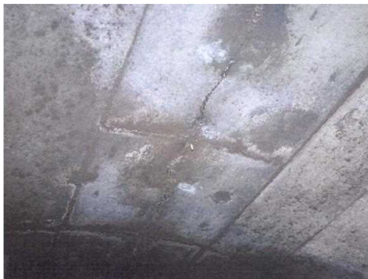
شکل ۳۷-۴ وقوع پدید ترک خوردگی در سقف تونل
