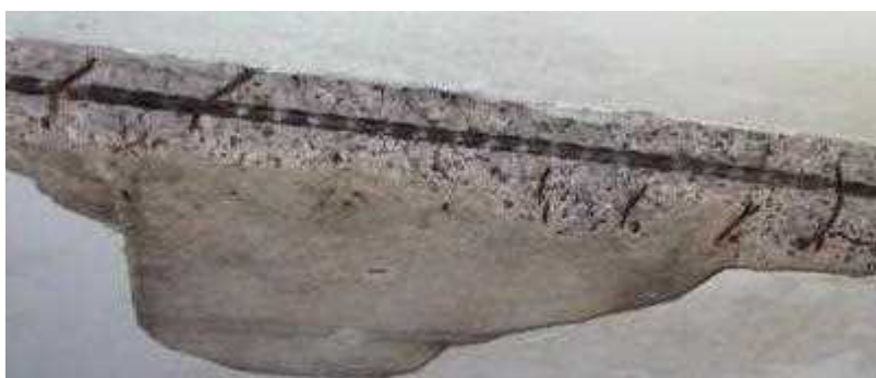
شکل ۱-۳۹ ریزش بتن در اثر پدیده پوسته‌شدگی
