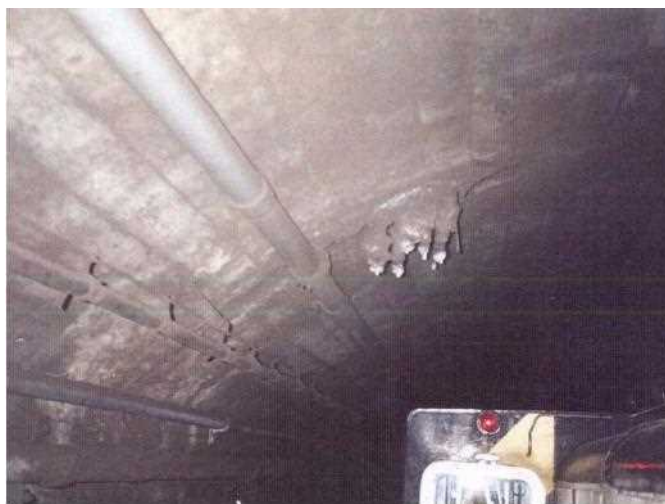
شکل ۴۳ → ریزش سقف تونل به دلیل نشت آب
