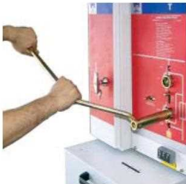
Operazione di manovra comandi Commissioning operation
