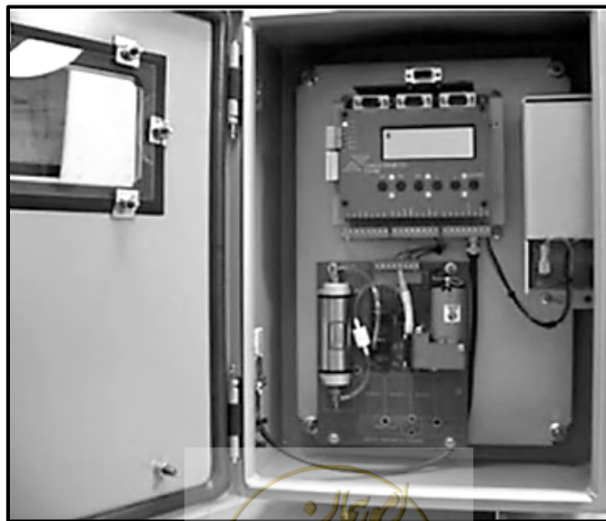
شکل ۳-۲۵- سطح‌سنج آب حباب‌ساز در داخل یک تابلو RTU.
