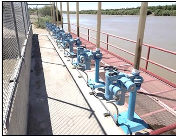
شکل ۳-۱۹- عمل‌گرهای دریچه‌های کشویی در ورودی مخزن تنظیمی
