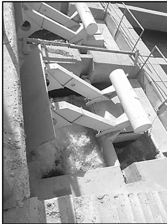
شکل ۳-۱۷- دریچه‌های آویس در شبکه آبیاری ورامین
