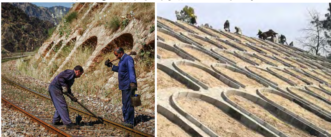
نگاره ۳۸: تثبیت ترانشه با قاب‌بندی، راست: بزرگراه حولیان، کراچی پاکستان، چپ: راه آهن لرستان
