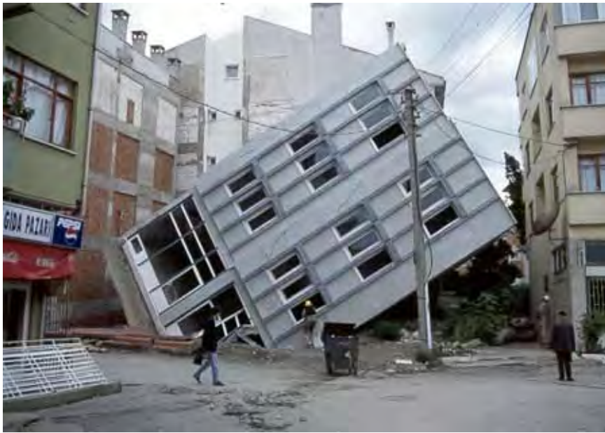
شکل ۱-۱۳- نمونه‌ای از کج‌شدگی و تخریب ساختمان‌ها در شهر Adapazari در زلزله‌ی Kocaeli
